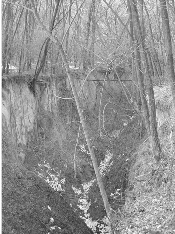
4. kép. A már kialakult eróziós árok az erdőben is tovább pusztul (Kisbabod mellett) The already existing gully will be further erode in the forest, too (near village Kisbabod)
