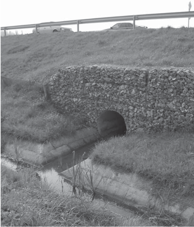
1. kép. Ökológiai alagút az M3 autópálya alatt Hejőkürt közelében. Ecological tunnel under the motorway M3, near Hejőkürt, Hungary
