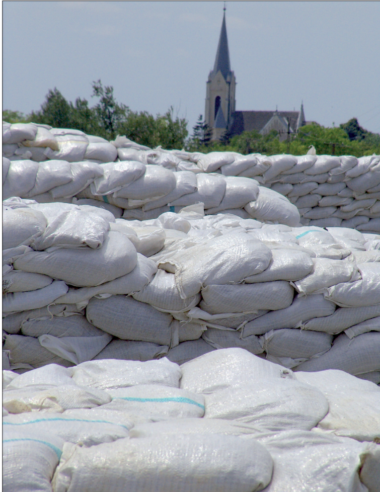
12. kép. Rézsűcsúszás és buzgár elleni védekezés 2006-ban a Hármaskörös árvédelmi töltésén Szelevénynél, ahol a lakosságot kitelepítették és a község csak "Isten kegyelmének" köszönhetően menekült meg az elöntéstől. (Fotó: SCHWEITZER F.)
