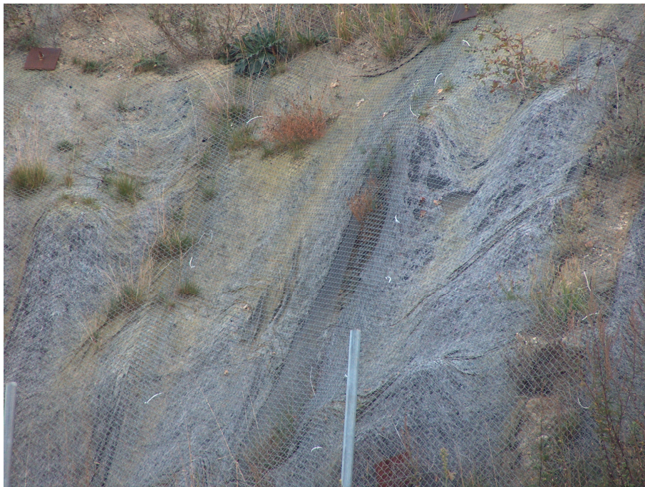
2. ábra Nyergesújfalu Sánc-hegy 11-es út melletti geotextiliákkal hatástalanul védett lejtője (Fotó: BALOGH J. 2009)
