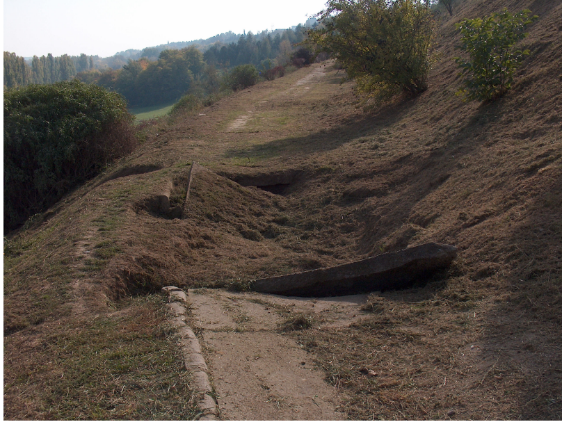
8. ábra. Szuffúziós folyamatok miatt károsodott partvédelmi út Dunaújvárosban a partfal-rehabilitáció előtt (Fotó: BALOGH J. 2008)
