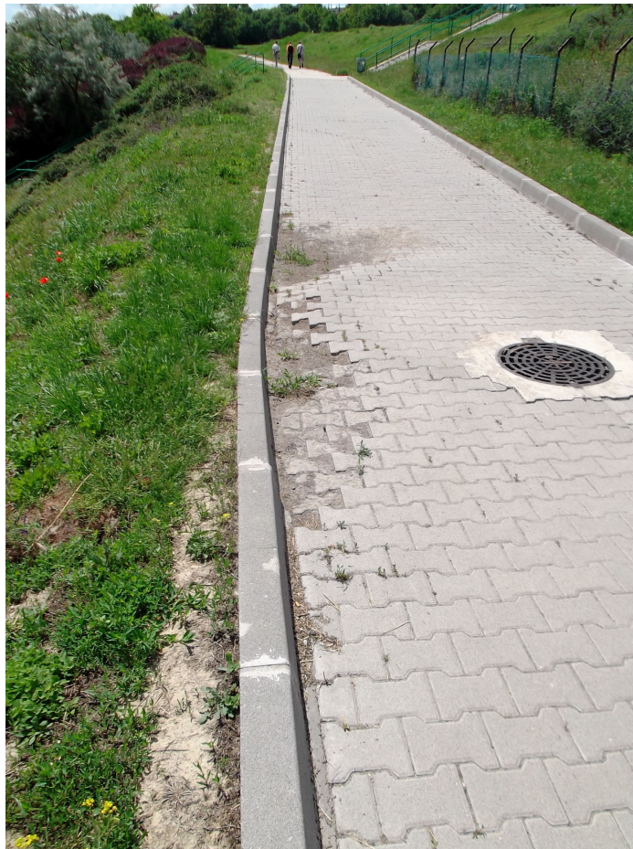
9. ábra. Szuffúziós folyamatok miatt károsodott partvédelmi út Dunaújvárosban a partfal-rehabilitáció után (Fotó: VARGA G. 2013)
