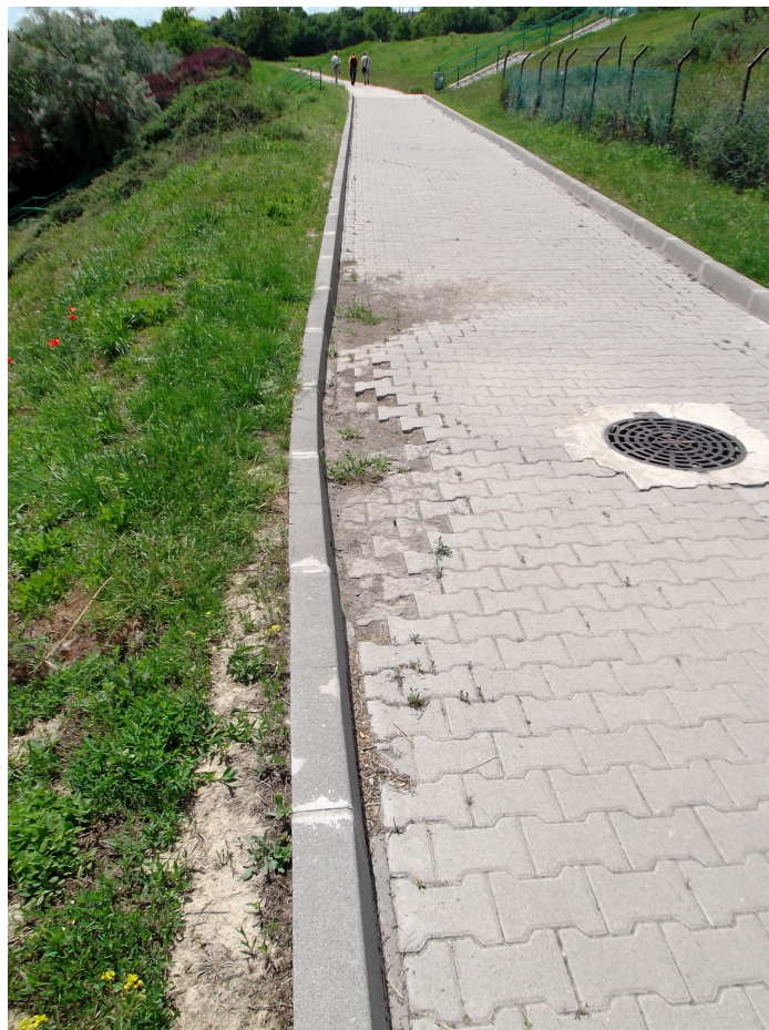
9. ábra. Szuffúziós folyamatok miatt károsodott partvédelmi út Dunaújvárosban a partfal-rehabilitáció után (Fotó: VARGA G. 2013)
