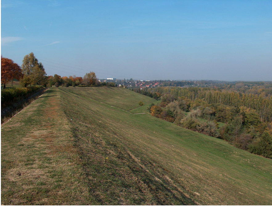
6. ábra. A dunaújvárosi rézsús partfalvédelem (Fotó: BALOGH J. 2008) Figure 6 Scarp protection at Dunaújváros (Photo by BALOGH, J. 2008)
