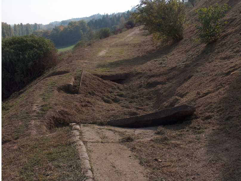
8. ábra. Szuffúziós folyamatok miatt károsodott partvédelmi út Dunaújvárosban a partfal-rehabilitáció előtt (Fotó: BALOGH J. 2008)
